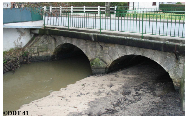
©DDT 41 Atterrissement obstruant partiellement l'arche d'un pont.
