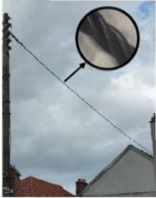
Réseau fils isolés aérien BT
