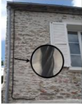
Réseau fils isolés façade BT
