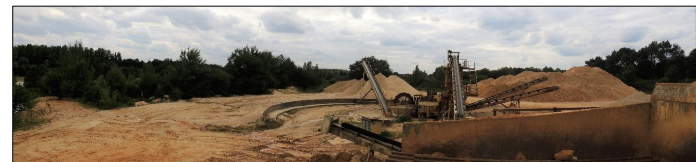
Installations de traitement des matériaux de la Carrière LANDRE sur la partie exploitée
