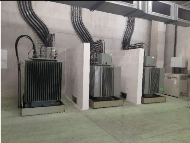
Transformateurs (3) dans le même local haute tension
