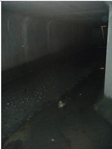
Fosse de collecte d'eaux pluviales
