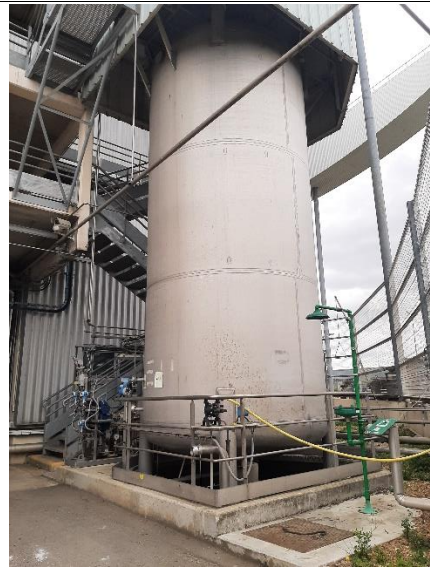
Cuve eau ammoniacale
