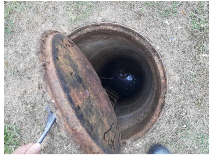
Séparateur HCT 1 : Unité de traitement 2
