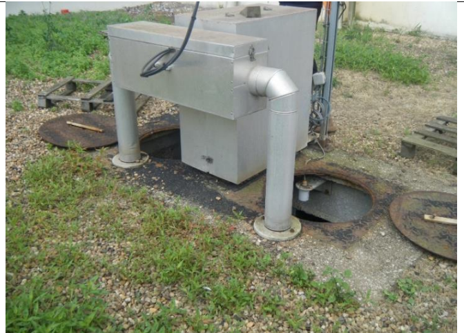
2 Cuves d'effluent acide
